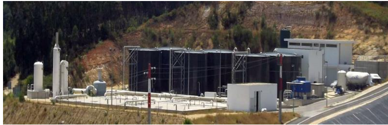
Estación de tratamiento de lixiviados- ABRUNHEIRA SOCAMEX
